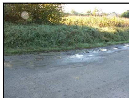
Présence d'eau sur la chaussée
